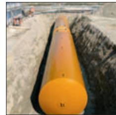
Tanklager Spitzenlastkessel - AFK-Geothermie
