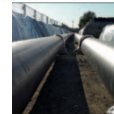
Fernwärmeleitung an der Energiezentrale Geovol
