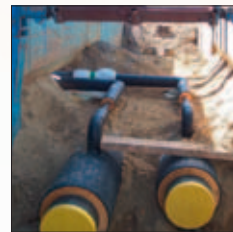
Fernwärmerohr mit Parallelabzweig - Pullach
