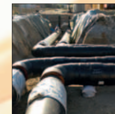
Ausdehnungsbögen DN300 Fernwärme - Unterföhring
