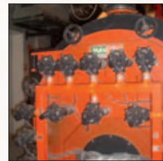
Biomassekessel-Druckluftreinigung - Schloss Elmau
