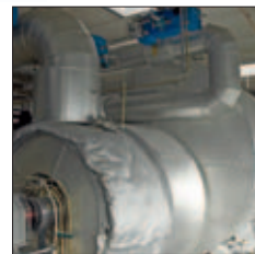
ORC-Turbine - Stromerzeugung Heizwerk Ainring
