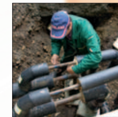
Muffen des Fernwärmerohr AFK-Geothermie
