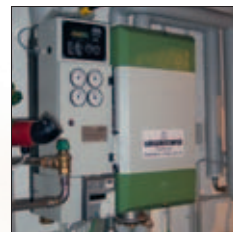
Fernwärme-Übergabestation Geothermie - IEP Pullach
